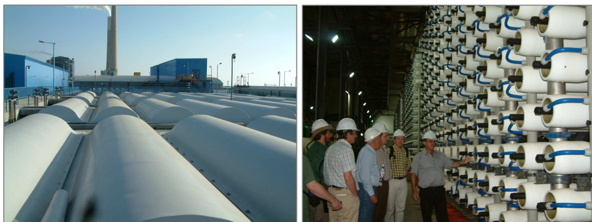
Figura A.5 - Detalhe do maior complexo de desalinização de água do mar existente no mundo, em Ashkelon, durante a visita de estudo a Israel (em Maio/2006)
