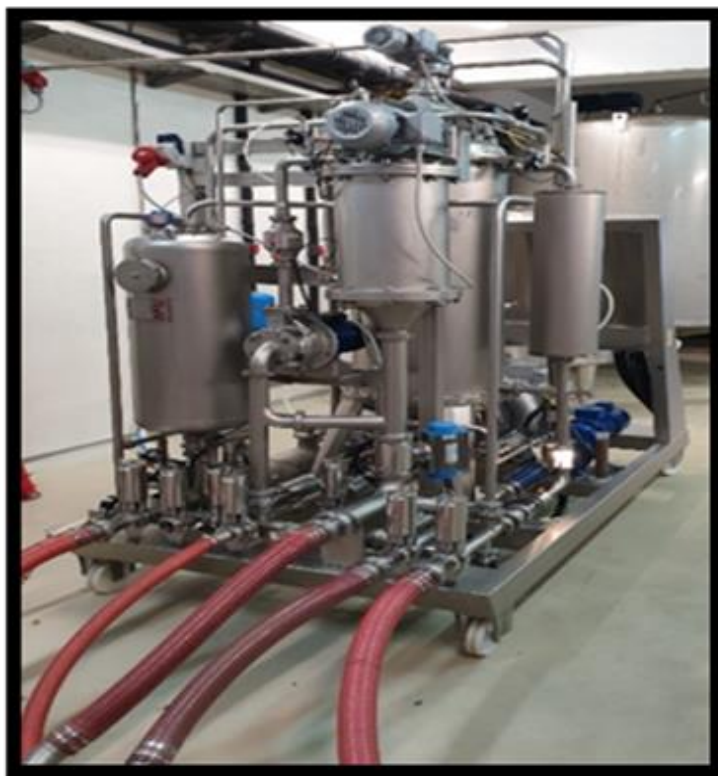
Figura 18 - Equipamento de filtração tangencial da José Maria da Fonseca
