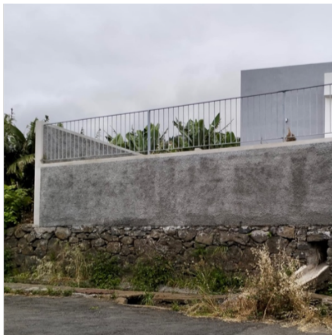
Figura 158: Muro de betão erguido sobre o antigo muro de pedra basáltica, que acompanha parte da levada do Curral e Castelejo. A nova construção ignora o lanço de água ainda funcional (no canto inferior direito), desperdiçando a oportunidade de reintegrar esse dispositivo – essencial durante séculos – na espacialidade da nova habitação. Trata-se também de um elemento que oferece o som da água a correr, enriquecendo a experiência sensorial do lugar. Onde antes o olhar do caminhante alcançava a plantação, hoje vê-se apenas um muro cinza e opaco de betão. (Fotografia tirada do ponto vermelho da figura 157).
