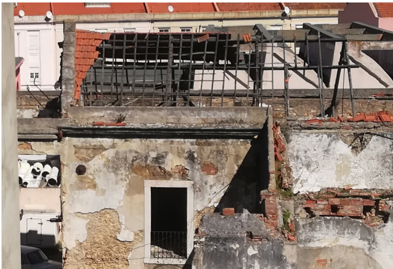
037. Vestígios da estrutura em madeira da Cobertura
