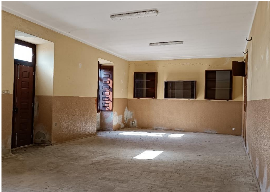
Figura 60 - Fotografia de uma das salas dos serviços da junta de freguesia. Reaproveitamento do pavimento – valor de utilidade (Fonte: autora).
