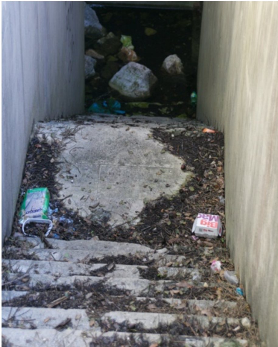
Figura 28: Depósito de lixo no acesso subterrâneo à Bateria nº2, pela autora.
