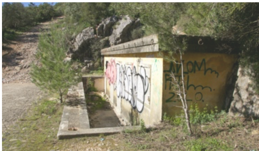
Figura 27: Abrigo da Bateria nº3 vandalizado, e emparedado, pela autora.
