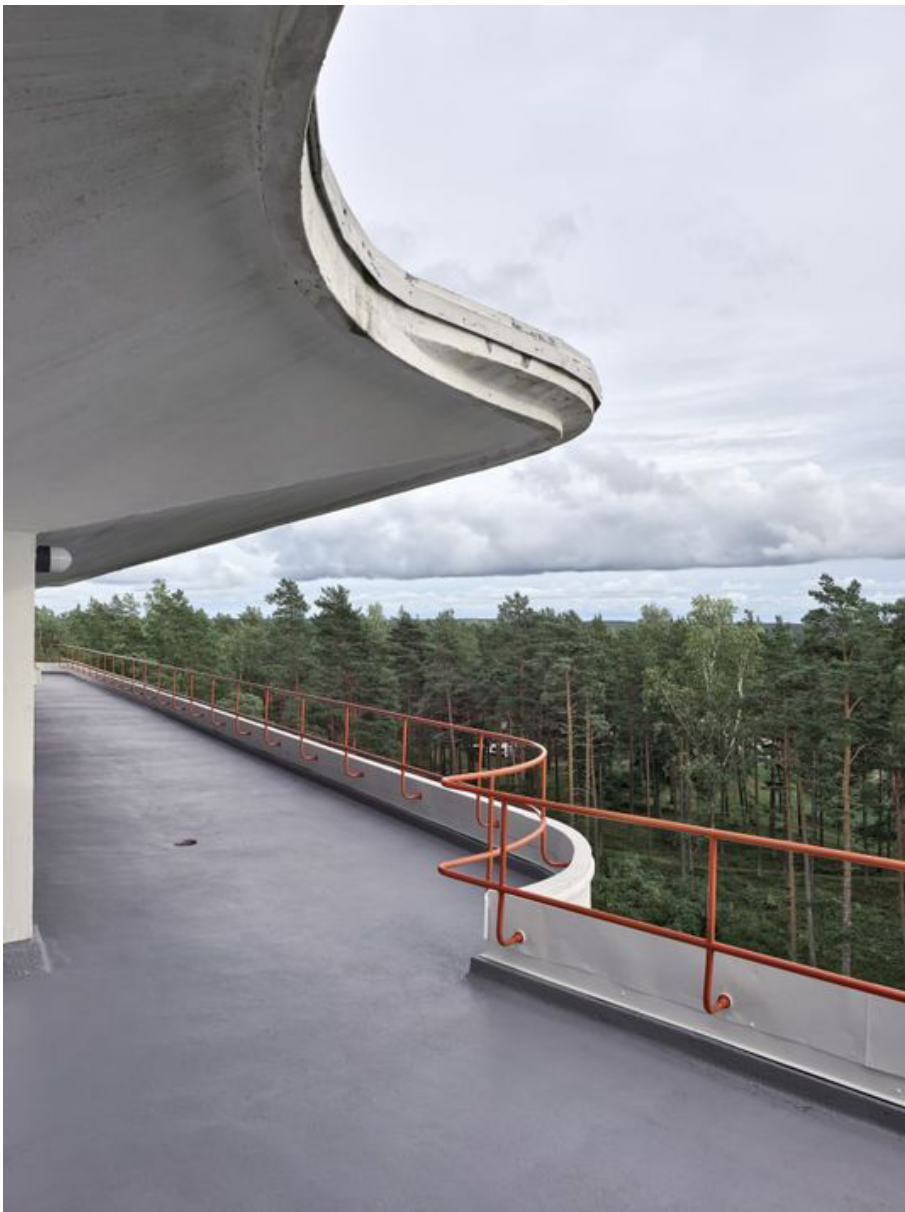
Fig. 42 | Terraço de Paimio Apesar de não haver uma cura conhecida durante o período de concepção do projeto, este assenta sobre diversas diretrizes consideradas imprescindíveis para o desenho de um sanatório: forte insolação, circulação de ar fresco, forte relação com a natureza
