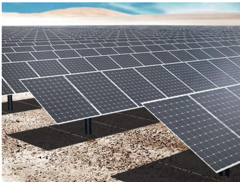
Figura 2.14 Agrupamento de painéis fotovoltaicos estacionários [27]
