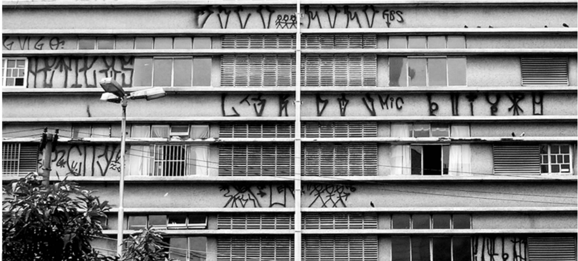
Fig. 19: Pixação en la fachada de un edificio
