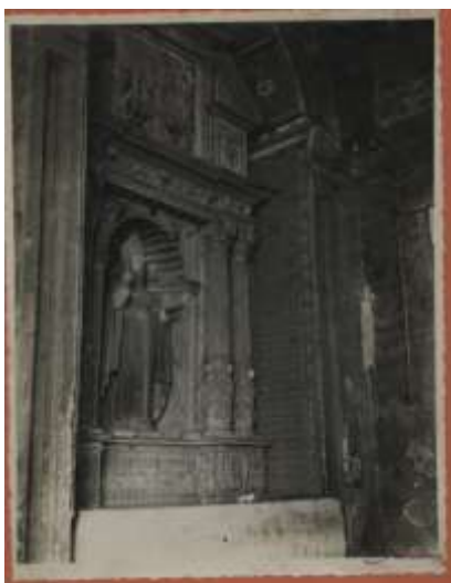
Imagem 253 Pormenor de uma capela do claustro das Mónicas em mau estado de conservação no ano de 1959. ANTT, FLB, cx. 4, pt. II, doc. 2.
