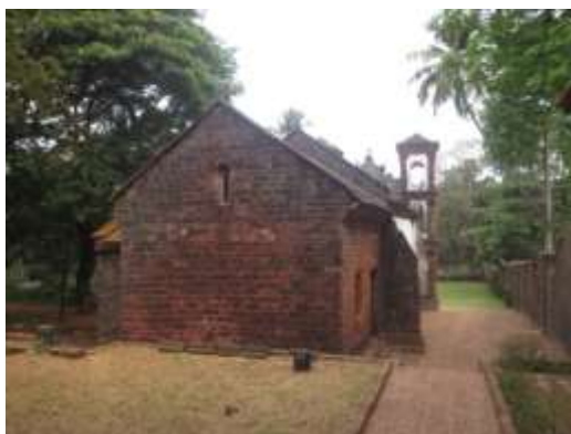
Imagem 242 Pormenor da frecha aberta na parede de fundo da capela-mor.
