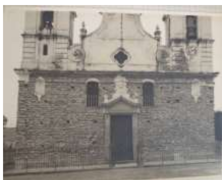
Imagem 108 A fachada principal da igreja de Nossa Senhora do Pópulo com parte dos rebocos picados, 1959. AINPCA, pt.28.2.
