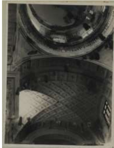
Imagem 255 Pormenor do mau estado de conservação da abóbada e zimbório da igreja da Divina Providência, 1959. ANTT, FLB, cx.4, pt. I, doc.5.
