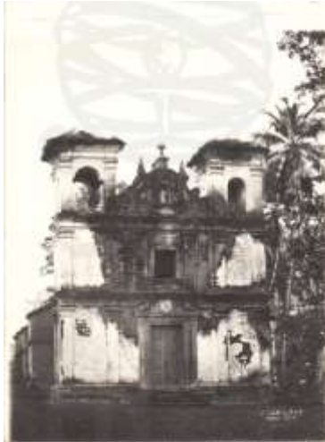
Imagem 245 O frontispício da capela com os rebocos muito danificados, s/d [fotografia publicada em 1930]. ACTDC/IICT, nº 26241.
