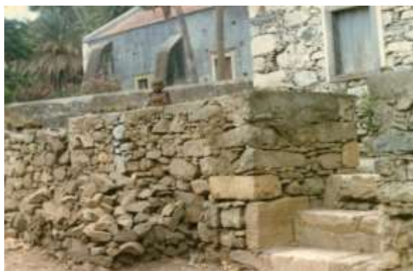
Imagem 80 Vista parcial do alçado lateral da igreja de Nossa Senhora do Rosário dos Pretos, 1981, sem o reboco que actualmente se observa. Fotografia cedida pelo arquitecto Alexandre Braz Mimoso.
