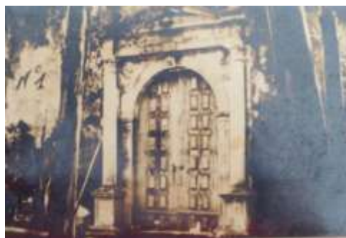
Imagem 36 Pormenor do estado do pórtico em cantaria antes do restauro, c. 1956-1958. AHSTP, doc. s/n.
