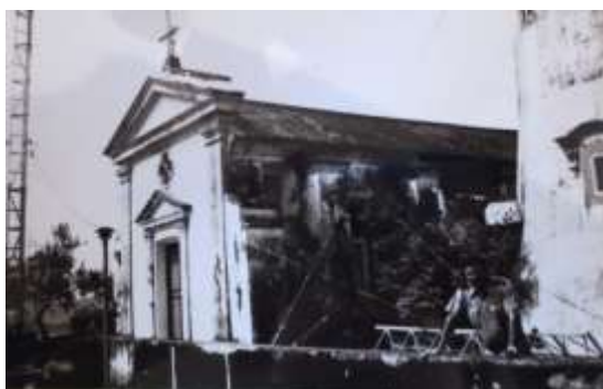
Imagem 308 Pormenor da capela da fortaleza no ano de 1973, sendo evidentes os problemas ao nível dos rebocos, situação que dez anos antes não se verificaria. IPAD, MU, DGOPC, GTPM, 2220, 00527
