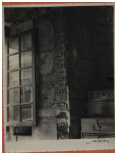
Imagem 254 Pormenor de trabalhos em alto-relevo carentes de restauro, 1959. ANTT, FLB, cx. 4, pt. II, doc. 2.
