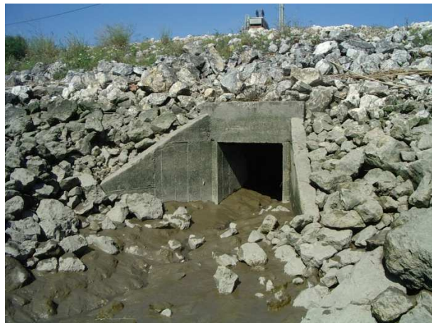
Figura III.9 – Ponto de Descarga de águas pluviais tratadas provenientes Parque de Combustíveis Sólidos (EH12).
