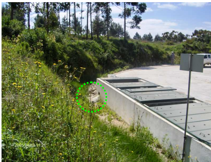
Figura III.12 – Ponto de descarga de águas residuais da garagem da pedreira (EH15).
