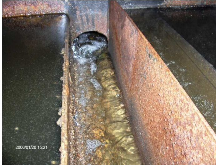
Figura III.7 – Descarga de águas residuais tratadas da LT1.
