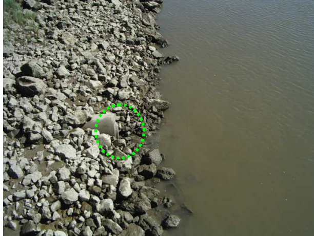
Figura III.8 – Ponto de Descarga de águas pluviais tratadas provenientes Parque de Combustíveis Sólidos (EH11).
