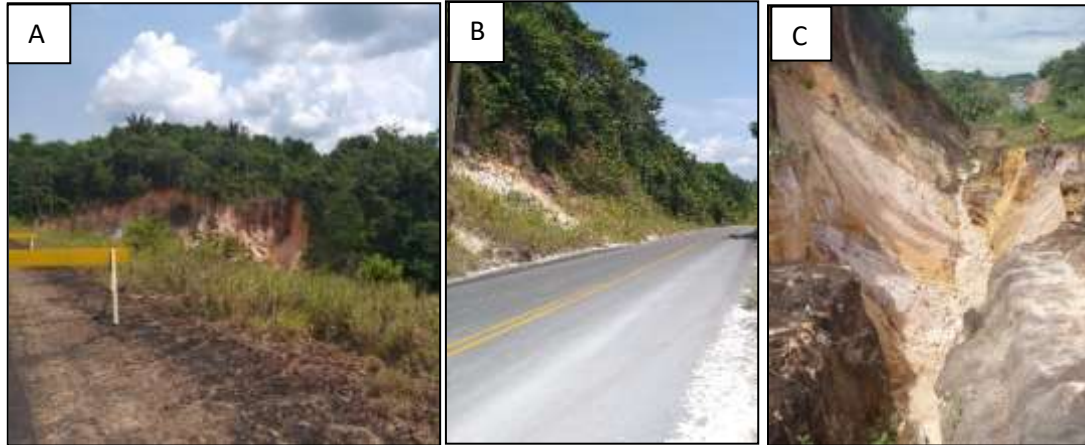
Figura 2.25 – Trecho da estrada interditado devido a presença de voçoroca (A); Movimento de massa (B); Voçoroca próximo a estrada (C). Fonte: Autora, 2020.
