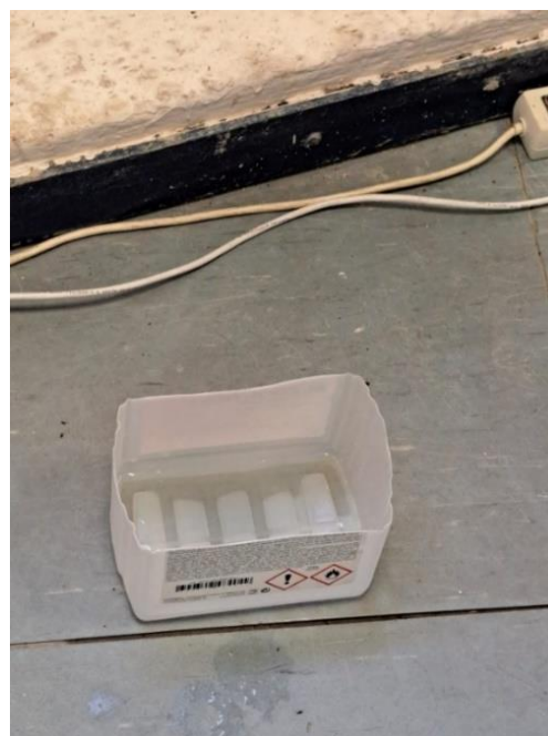
Figura 8 – Recipiente colocado com a finalidade de recolher a água pluvial proveniente de infiltrações do teto (área dos serviços administrativos)
