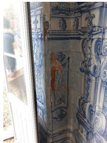
Figura 43 – Foto dos Danos nos Azulejos na Entrada Principal do Convento
