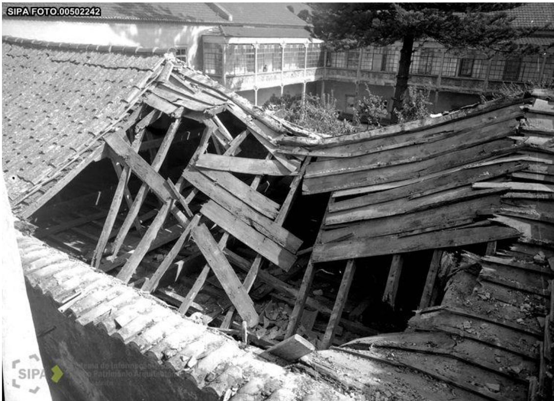
Danos no Telhado do Convento de Nossa Senhora da Boa-Hora 1952 in CML
