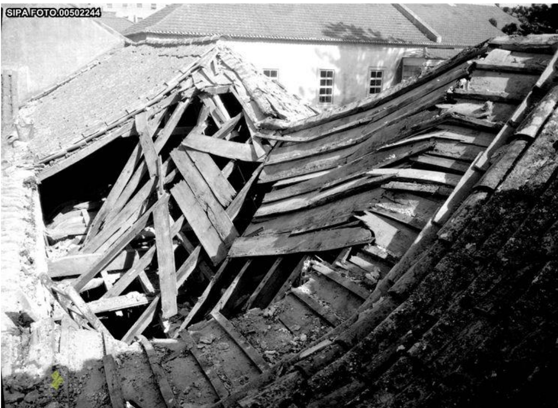
Danos no Telhado do Convento de Nossa Senhora da Boa-Hora 1952 in CML
