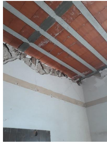
Figura 42 – Foto da estrutura em betão danificada
