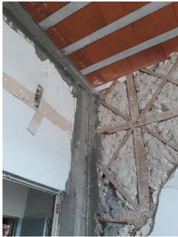
Figura 41 – Foto da estrutura em betão danificada
