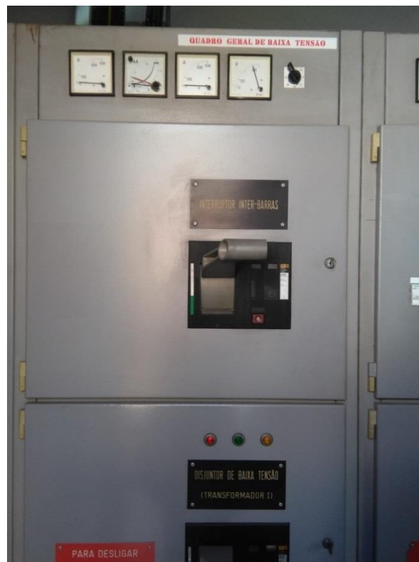
Figura 4.20 - Quadro geral de baixa tensão (QGBT), interruptor inter-barras e disjuntor de baixa tensão
