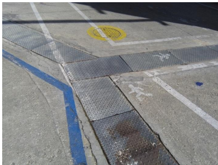
Figura 4.22 - Exemplo de caleiras técnicas ao longo das instalações da Dyrup
