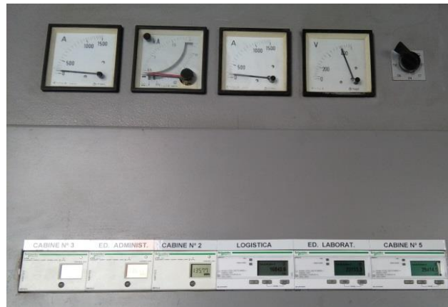
Figura 4.19 - Contador parcial das instalações da Dyrup
