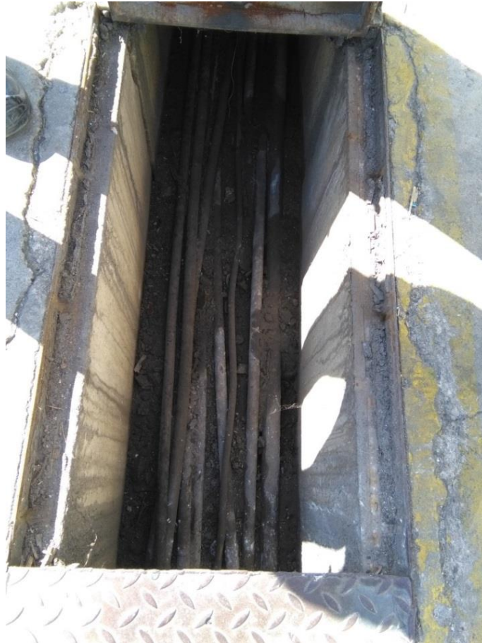
Figura 4.23 - Interior de uma caleira
