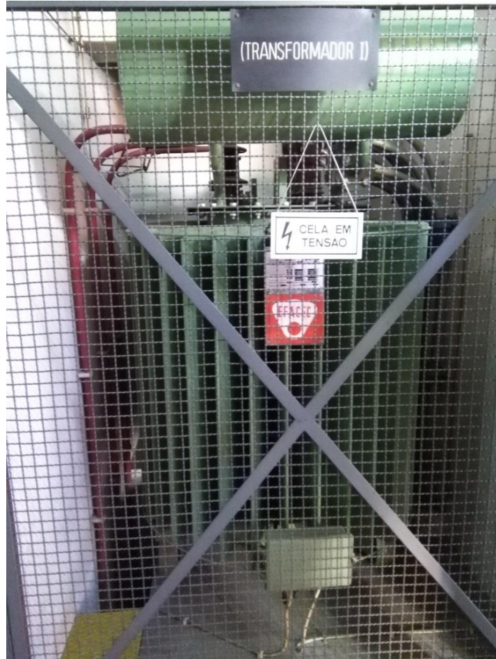
Figura 4.21 - Armária de interligação com a rede (transformador)
