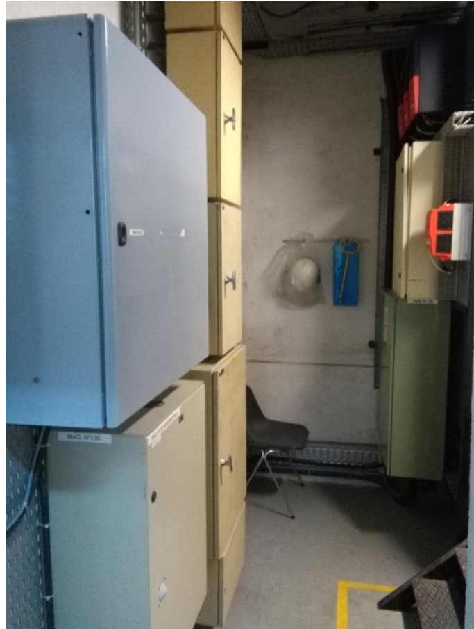
Figura 4.17 - Vista interior da sala onde serão colocados os inversores (parede branca)
