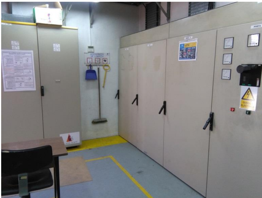
Figura 4.16 - Vista interior da sala onde será realizada a interligação ao quadro parcial
