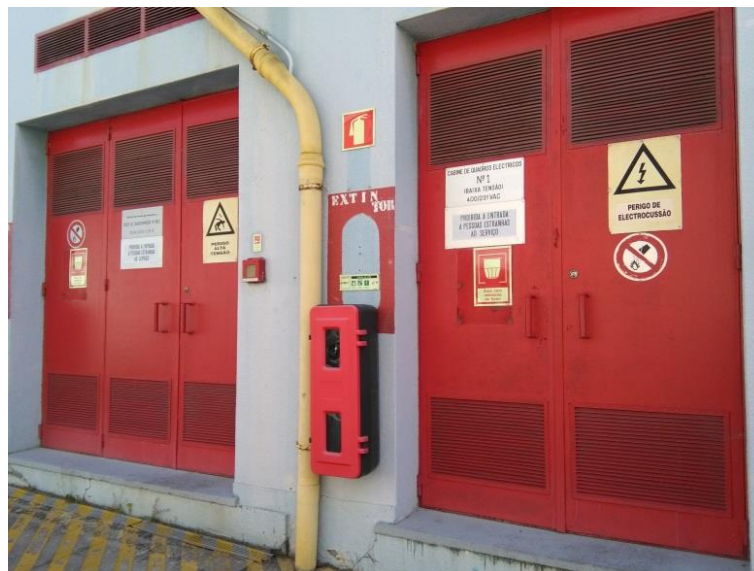
Figura 4.18 - Vista exterior das salas de baixa tensão e do posto de transformação (AT)
