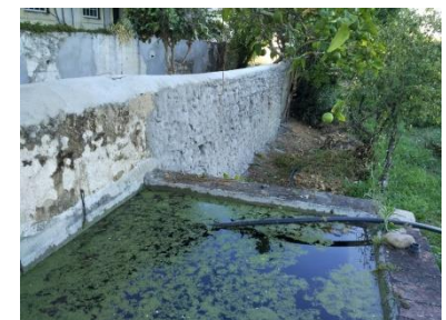
Fig. 40 recuperação incorrecta de um muro de taipa
