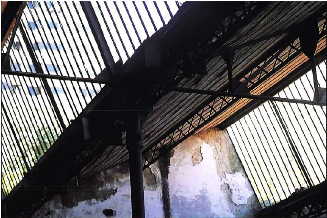
Fig 36. A degradação e abandono das estruturas industriais existentes.
