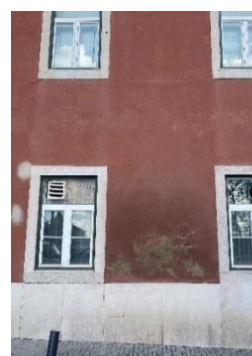
25. Anomalias da fachada principal do edifício, 2022
