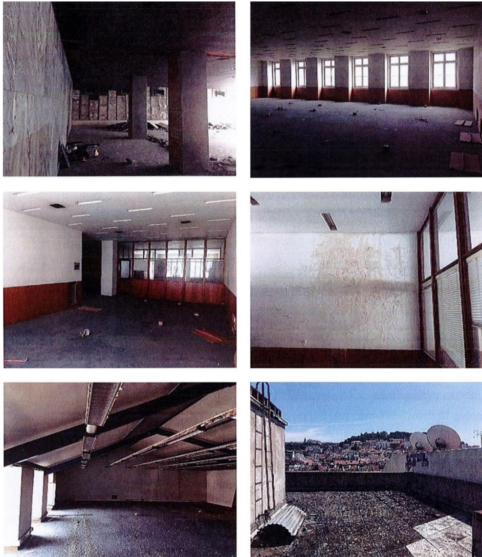
Fig. 8.15 – Da esquerda para a direita e de cima para baixo: Vista geral do piso 1; vista geral do piso 2; vista geral do piso 3; divisórias de madeira no piso 3; vista geral do piso 4; cobertura em terraço (Fotografias de Vasco Appleton, 2018)
