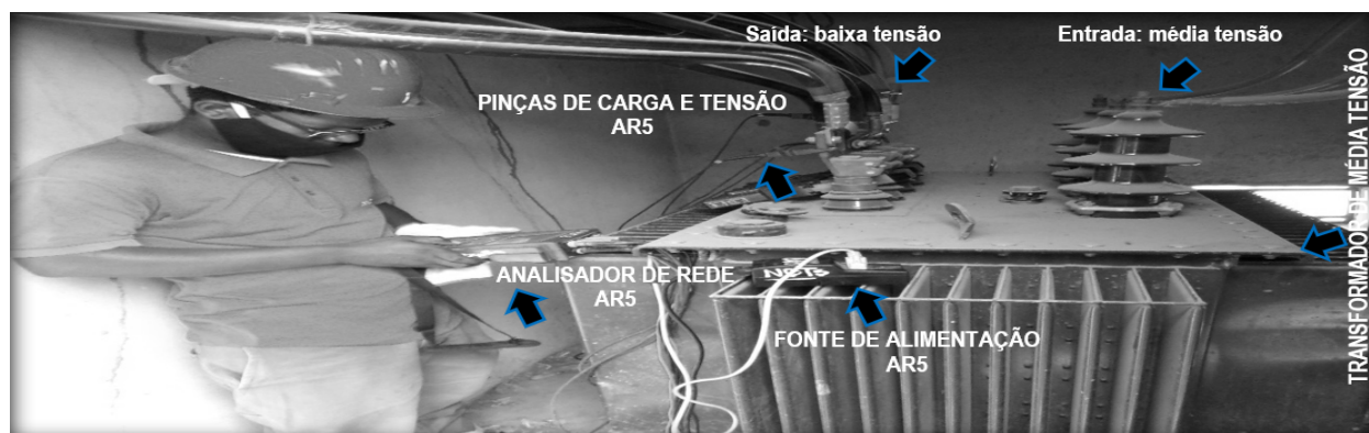
Figura 4.20. Transformador de média tensão: componente mecânica/analógica do setor
