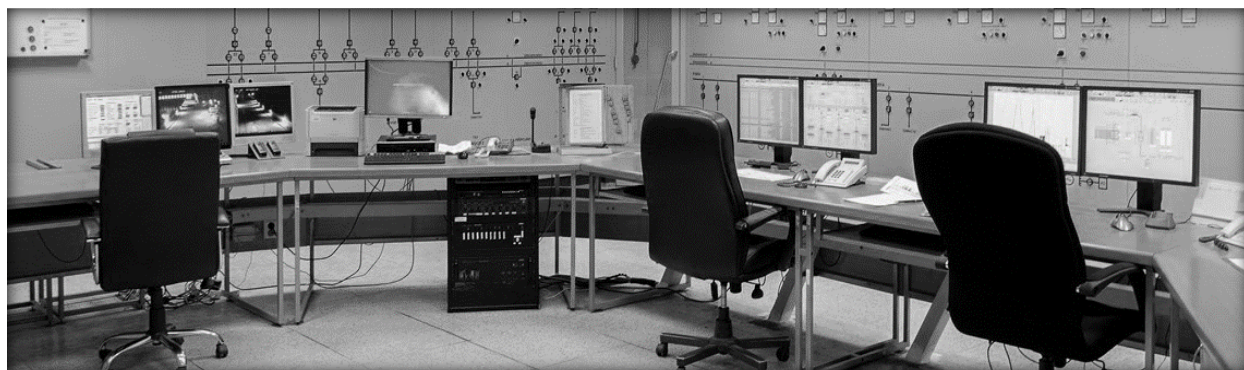
Figura 4.7. Parte da sala de controlo do sistema elétrico angolano: “centro de despacho”
