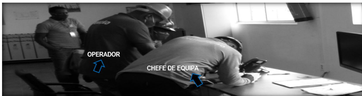
Figura 4.10. Momento em que o chefe de equipa atesta que há condições para trabalhar na linha número 6 Fonte: (Observação participante: sala de comando da subestação da Filda).
