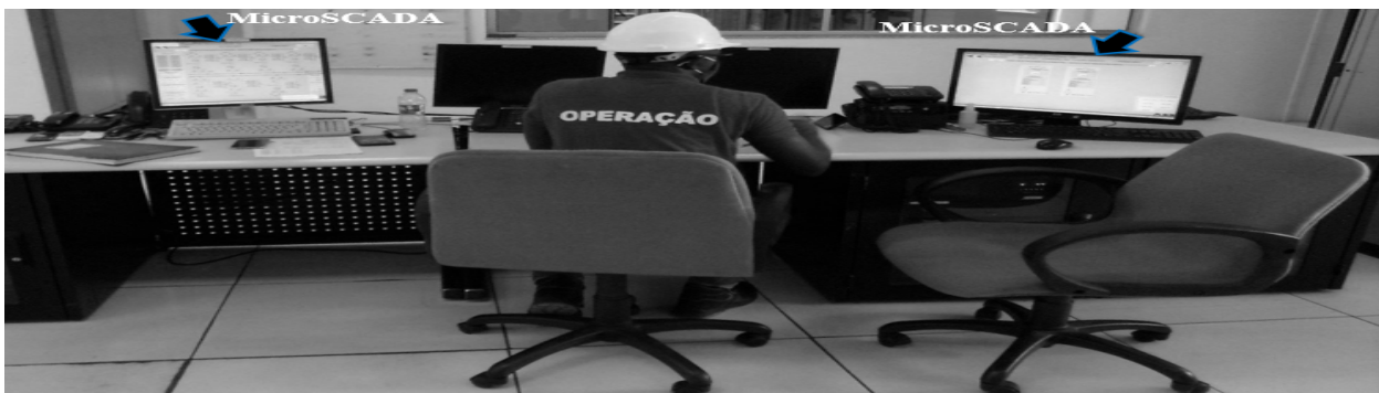
Figura 4.14. Sistema MicroSCADA: monitoramento de subestação à distância Fonte: (Visita guiada à sala comando da subestação de Viana, em Luanda).
