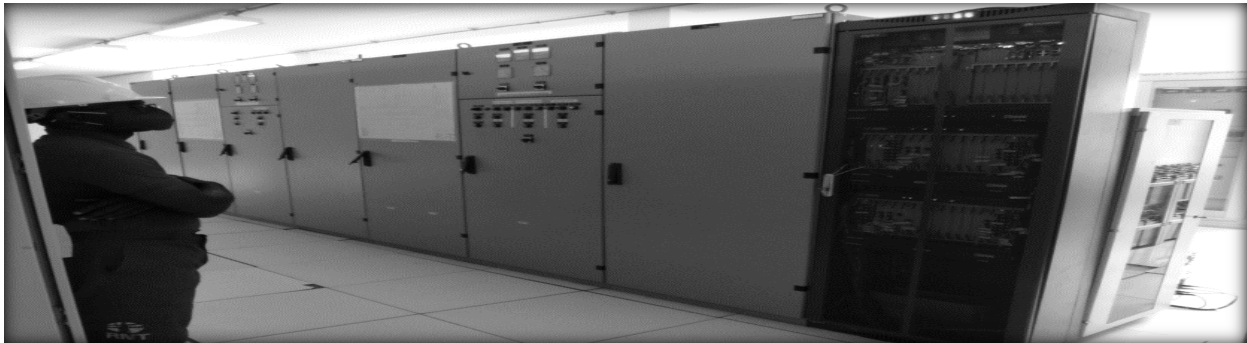
Figura 4.13. Quadro de instrumentos da sala de comando: componente digital da subestação de Viana Fonte: (Visita guiada à área de apoio à sala de comando da subestação de Viana, em Luanda).
