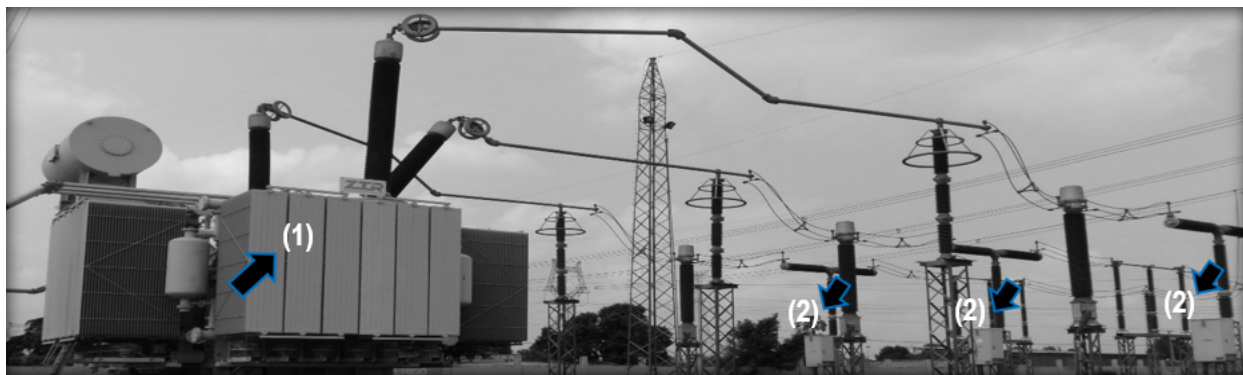
Figura 4.6. (1) Transformador de alta tensão: parte mecânica; (2) Quadro elétrico: parte elétrica
