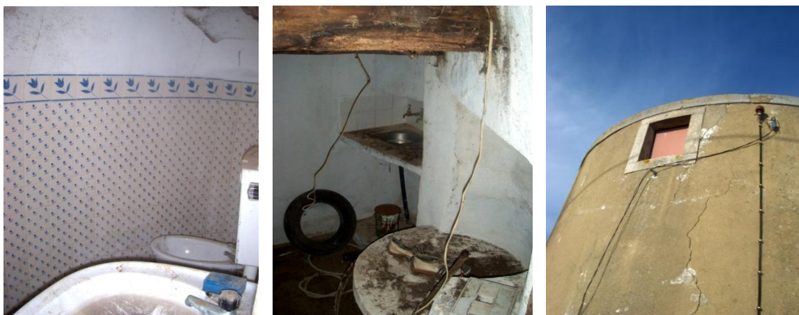
Fig. 43 | Instalações sanitárias de um moinho de vento do Oeste reconvertido em habitação, em Vila Verde dos Francos. Fonte: Fotografia da autora. Fig. 44 | Piso térreo de um moinho de vento do Oeste reconvertido em habitação, em Vila Verde dos Francos. Fonte: Fotografia da autora. Fig. 45 | Aspecto exterior actual de um moinho de vento do Oeste reconvertido em habitação, em Vila Verde dos Francos. Fonte: Fotografia da autora.
