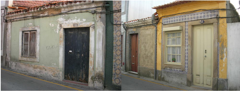
Figura 4.1 – Casas típicas do Bairro da Beira-Mar em estado de degradação (2007).
