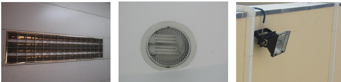
Figura 3.3 - Exemplo do tipo de iluminação fluorescente tubular T8, compacta fluorescente e vapor de mercúrio de alta pressão, respetivamente, nas instalações.
