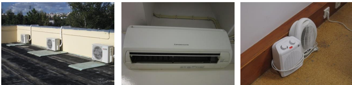
Figura 3.2 - Exemplo de unidades de condicionamento do ar presentes no edifício.
