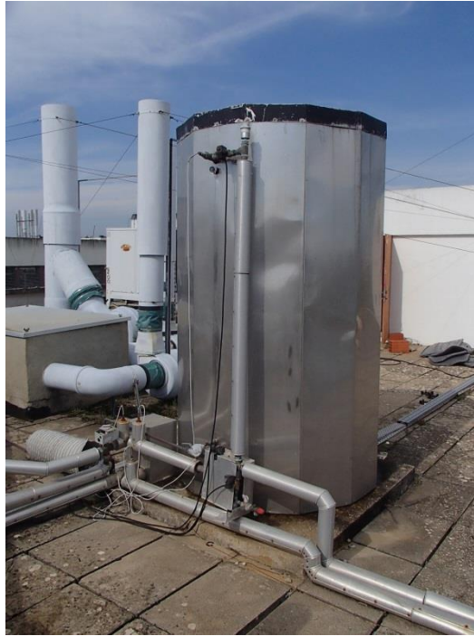
Figura 33: Depósito de Armazenamento de Energia
