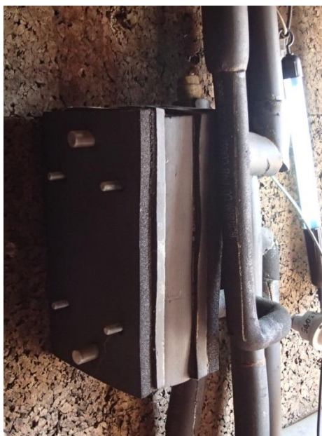
Figura 34: Permutador no interior da sala técnica junto à caldeira
