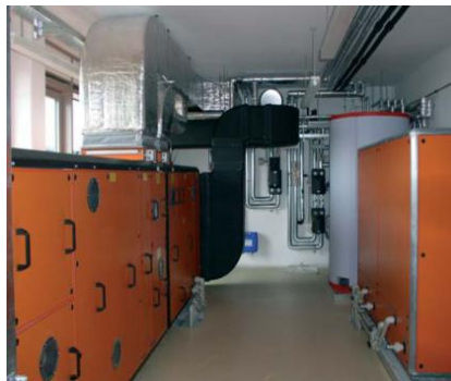
Figura 19: UTA no Centro de Informação Solar em Friburg [49]
