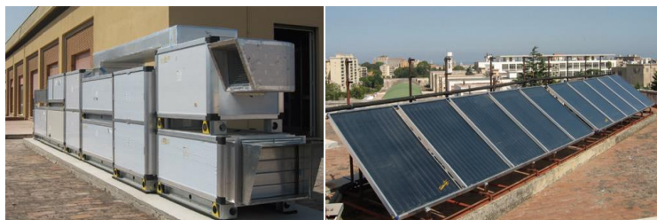
Figura 17: UTA e painéis solares instalados na universidade em Palermo [70]
