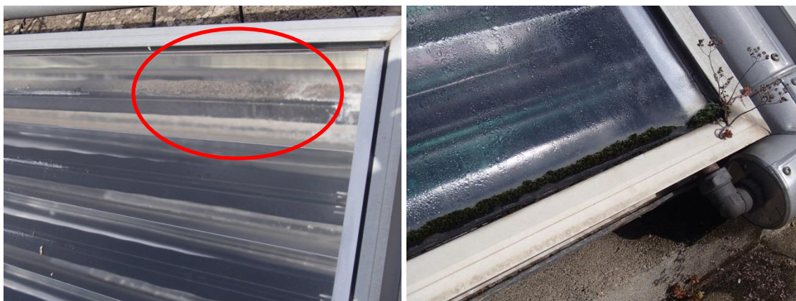
Figura 43: Danos detetados nos coletores
