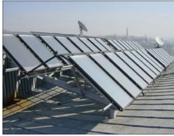
Figura 18: Painéis solares instalados na universidade Americana da Arménia [71]
