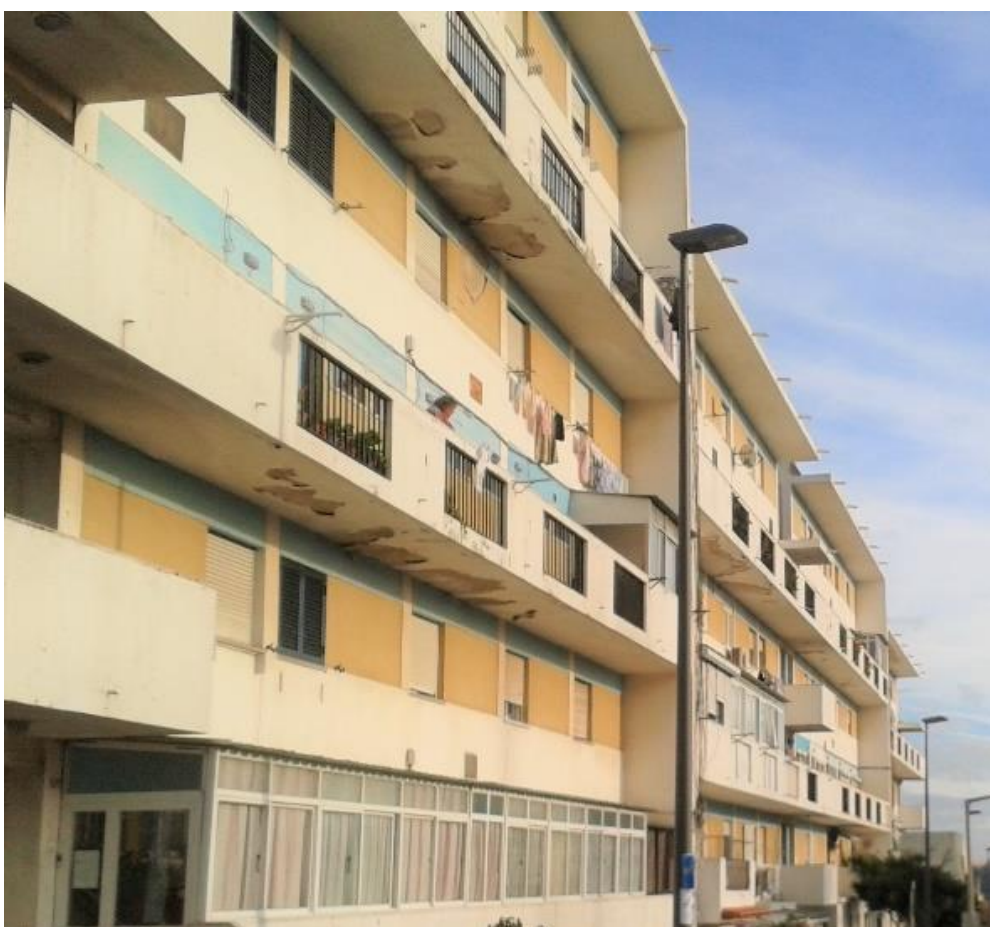
Fig. 65 Degradação dos espaços construídos no Bairro do Casalinho da Ajuda, Lisboa, fotografia da autora, setembro de 2018
