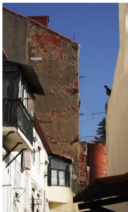
Fig. 23 – Actual estado de degradação do edifício, visto do Pátio das Beatas
