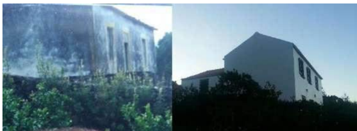
Figura 6 - Quinta do Cabeço, 1987 antes da renovação (à esquerda). Quinta do Cabeço, 2017. Vista do Alçado Leste (à direita). ©Lizuarte Machado
