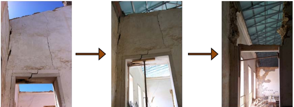
Figura 72 - Neste vão de passagem da Sala B para a Sala C foi possível observar a evolução de uma das anomalias, desde a fissuração ao desabamento.
