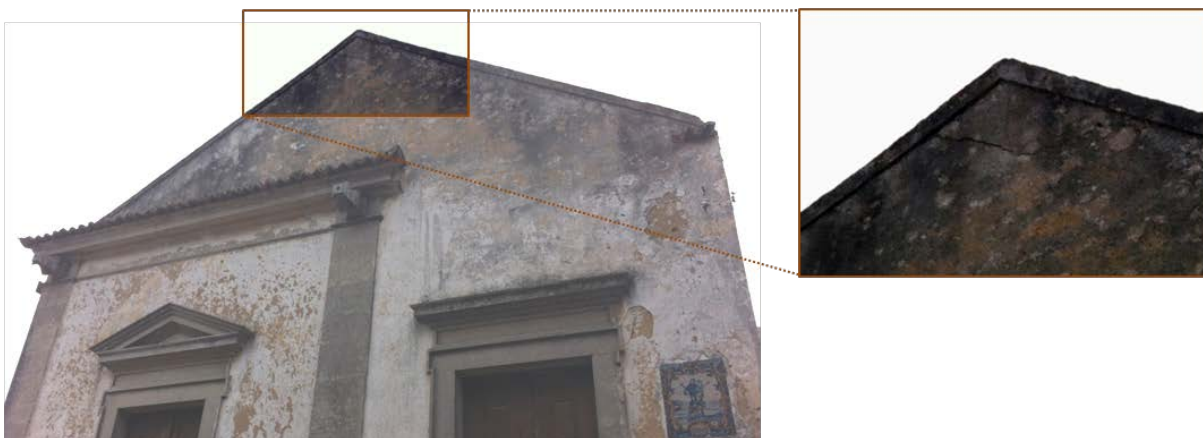
Figura 64 - Fissura no topo da Fachada Este do palácio sugere o destacamento e perigo de derrocada da cumeira.
