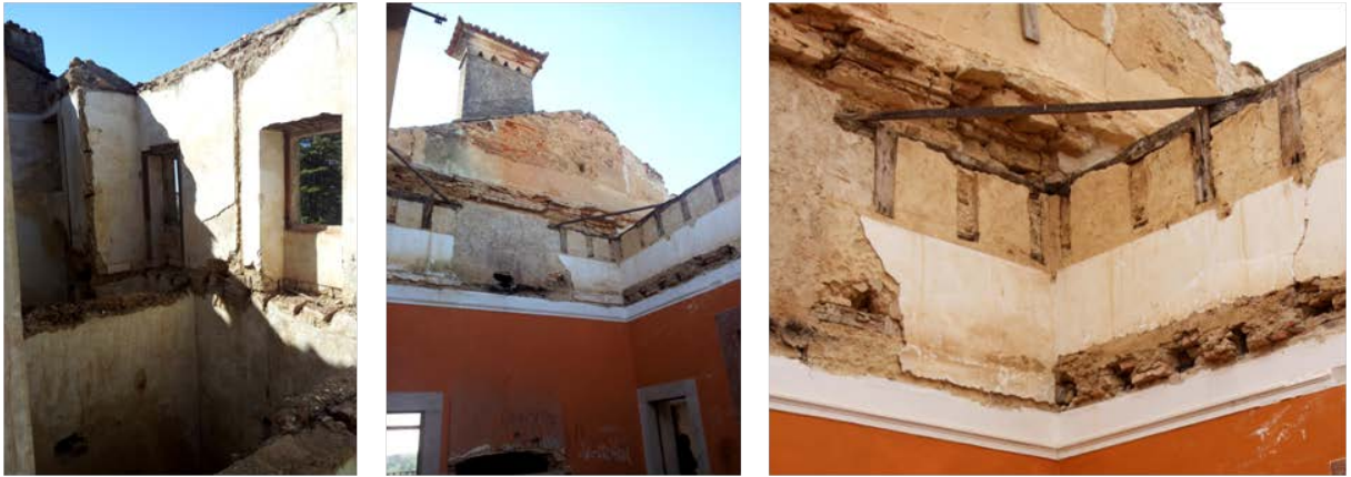
Figura 71 - Inexistência de tetos ou pavimentos vem agravar a evolução das anomalias causadas na estrutura pela entrada de águas pluviais.
