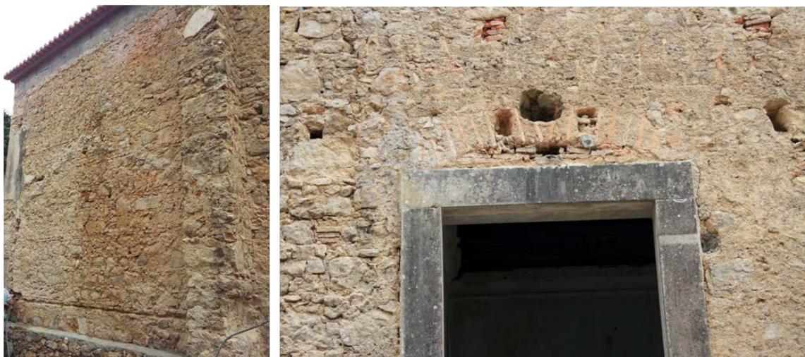
Figura 60 - A remoção do reboco deixa à vista vários sinais que marcam a evolução estratigráfica do edifício.
