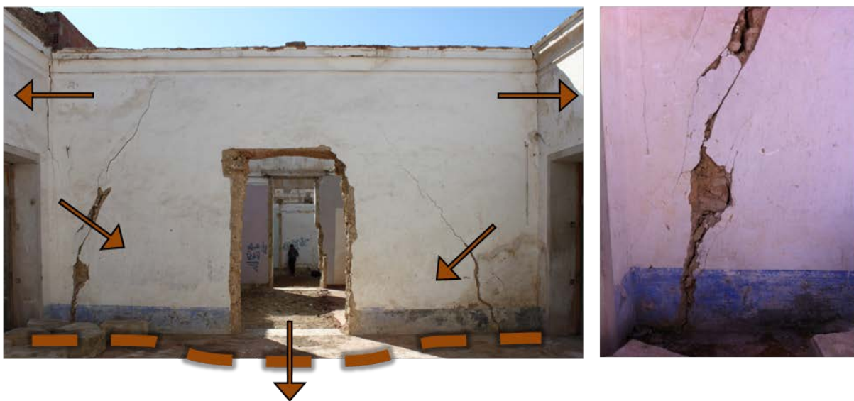
Figura 63 - Análise da fendilhação na parede oposta à analisada na Figura 52 da Sala C. As setas representam as forças a atuar e conseqüentes movimentos estruturais. À direita uma imagem de pormenor.
