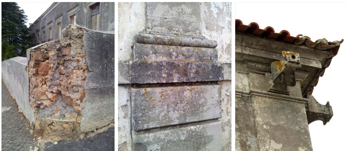
Figura 76 - Nos elementos de pedra as principais anomalias são o desgaste da pedra, a sujidade, e fluorescências, fendilhação, fratura e demolição parcial.
