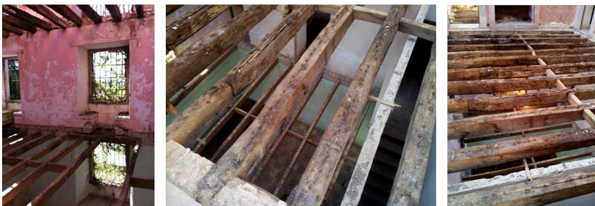
Figura 70 - O avançado estado de degradação nos pavimentos de madeira levou à remoção das tábuas de revestimento.
