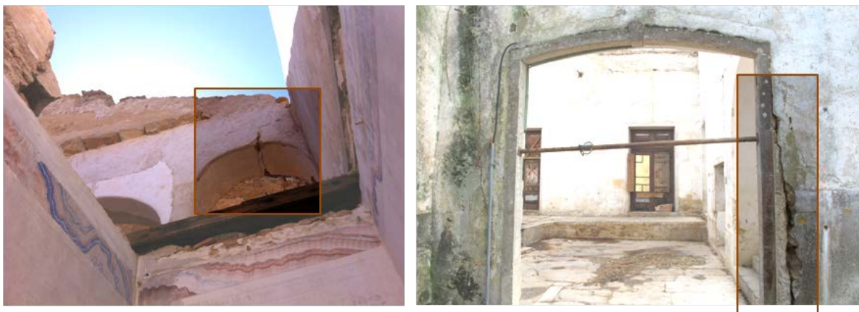
Figura 68 - À esquerda é possível observar a fissuração de um arco no topo Oeste do palácio. À direita observa-se uma fissura na abertura, a Norte, para a Sala B.
