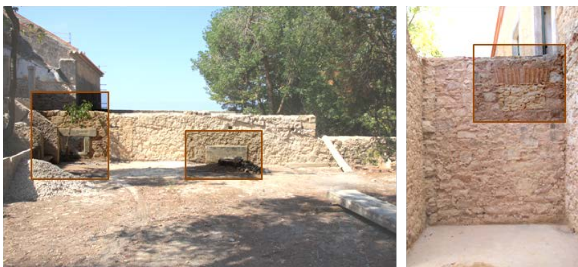
Figura 61 - Com a remoção do reboco, surgem vãos semienterrados pela cota atual do terreno.
