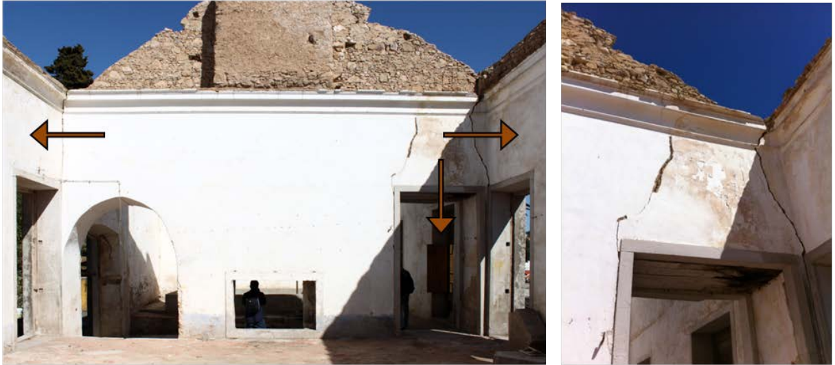
Figura 62 - Análise da fendilhação numa das paredes da Sala C. As setas representam as forças a atuar e consequentes movimentos estruturais. À direita uma imagem de pormenor.
