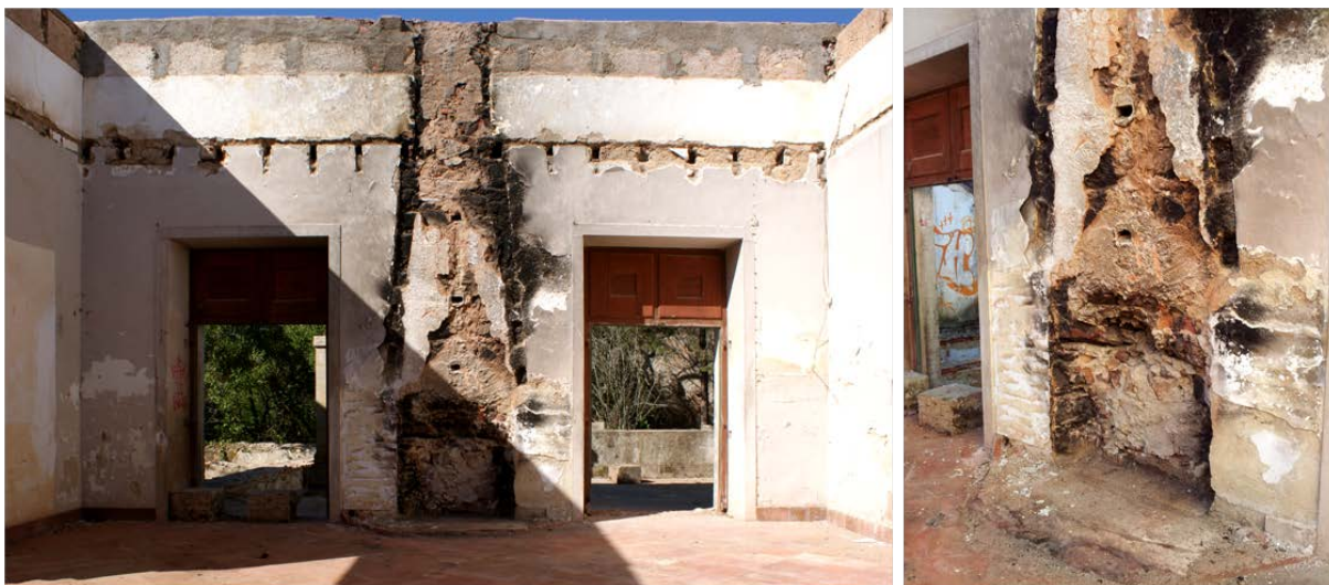
Figura 78 - Anomalia consequente das ocupações ilícitas do edifício.
