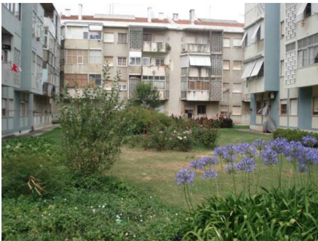
Figura 21 - Edificado envelhecido (Rua da Ilha da Madeira, Olival Basto)
