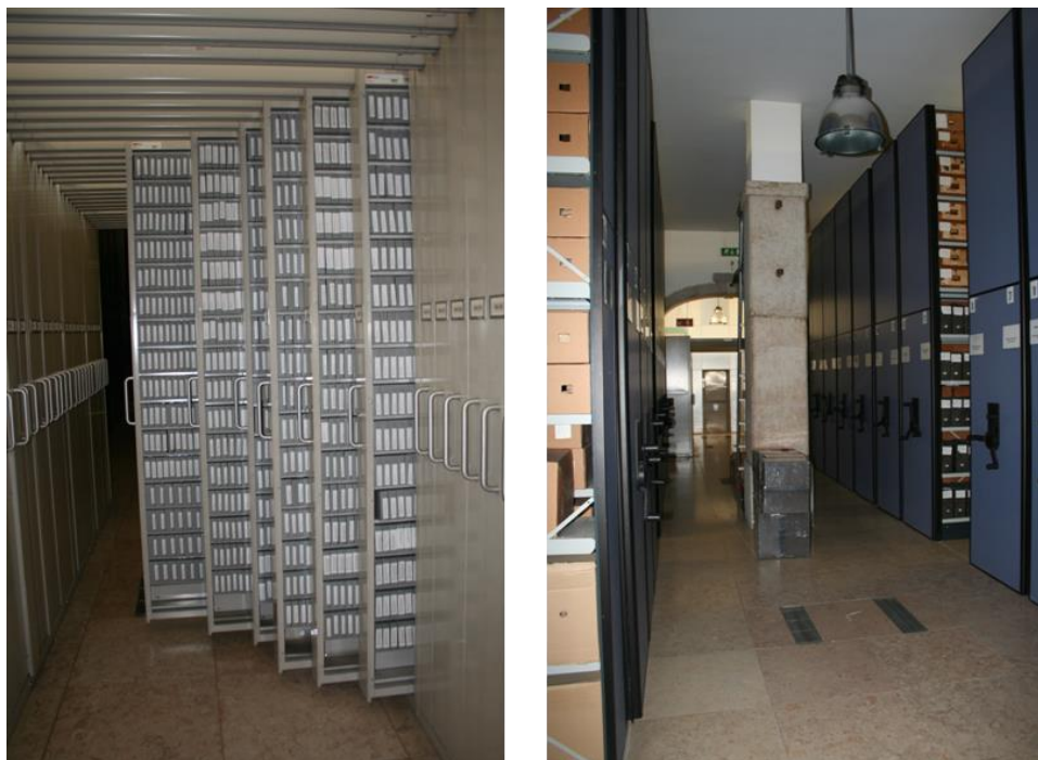
Figura 17 - Pormenores do depósito de microfimes e de papel, vendo-se na segunda imagem a calha subterrânea onde circula o ar condicionado para manter as condições climatéricas estáveis
