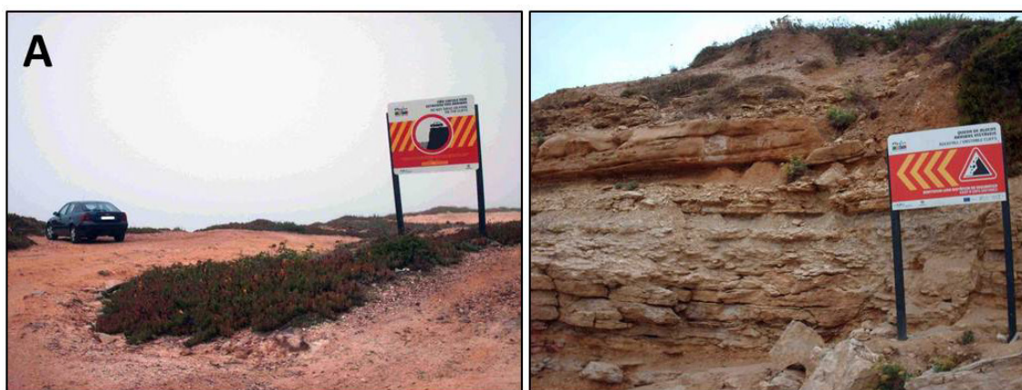
Figura 1.2 – Sinalética de aviso relativamente a perigo causado por arribas instáveis. A - Apesar do aviso “Não circule, nem estacione nas arribas”, encontra-se um automóvel estacionado no topo da arriba. Fotografias de Agosto de 2011.
