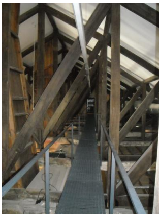
Figura 91 - CAV- galeria técnica [35]
