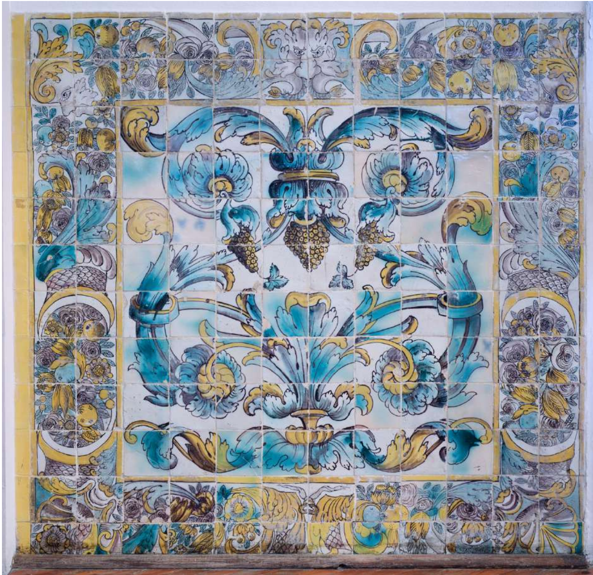
Fig. 22 – Secção da sala LX_BL_PCC_02 em que é bem visível o verde cobre “espalhado” sobre o vidroado branco. Fotografia Emigus / Az Infinitum.
