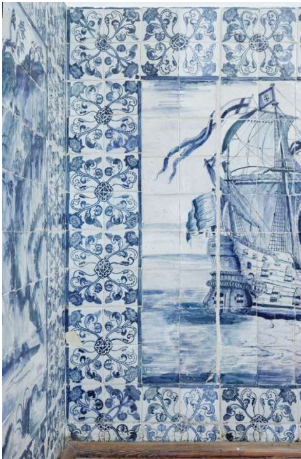
Fig. 134 – Sala LX_B_PCC_07, parede 2, seção 1, fenda causada pelo derrube da parede que dividia a sala LX_B_PCC_04. Fotografia Emigus / Az Infinitum.
