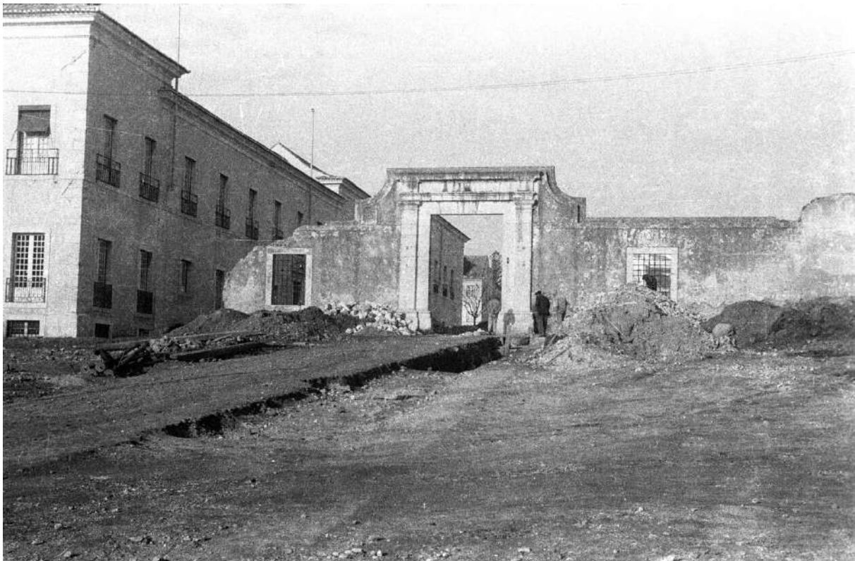
Fig. 104 – Pátio das Vacas. Corte do muro para colocação de calçada junto do edifício. Foi também aplicada uma pilastra de cantaria no local onde o muro entroncava. É possível observar ainda duas das chaminés das salamandras. UL-IICT-Col.FOTO-JBT_25917. S.d.
