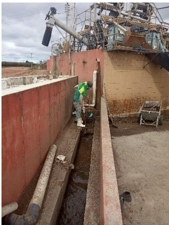
Figura 54 - Canal que condução da água
