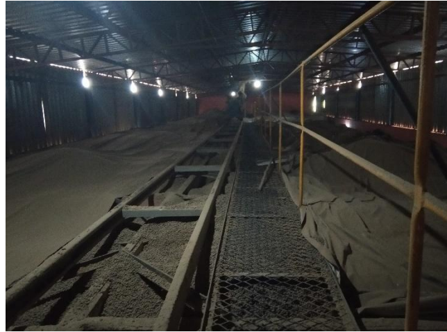
Figura 42 e Figura 43 - Tulhas de armazenamento
