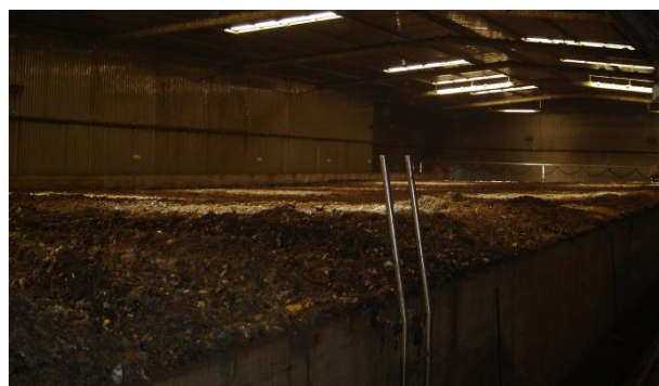
Figura 24 - Pormenor do túnel de compostagem com todas as zonas completas.
