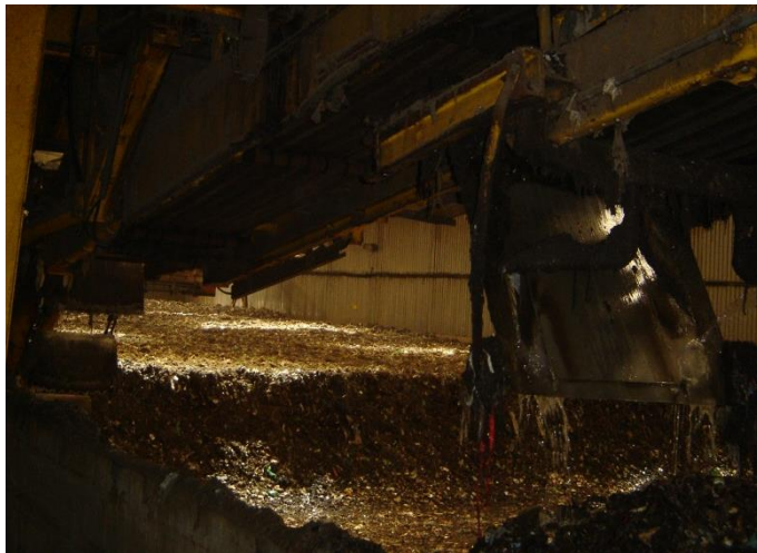
Figura 23 - Máquina de revolvimento: pás de revolvimento (à esquerda) e adição de água a uma zona do túnel (à direita).
