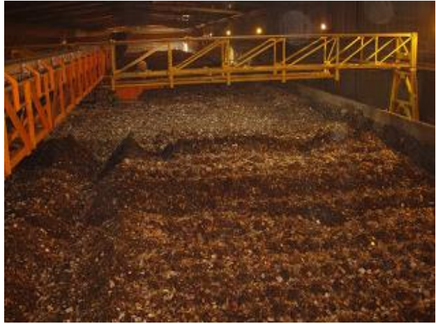
Figura 22 - Vista geral do interior do pavilhão de compostagem.
