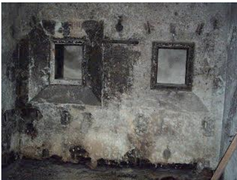
Fig. 26 – Patologia secundária – Efflorescências, RAC (2011), edição: Rúben Henriques
