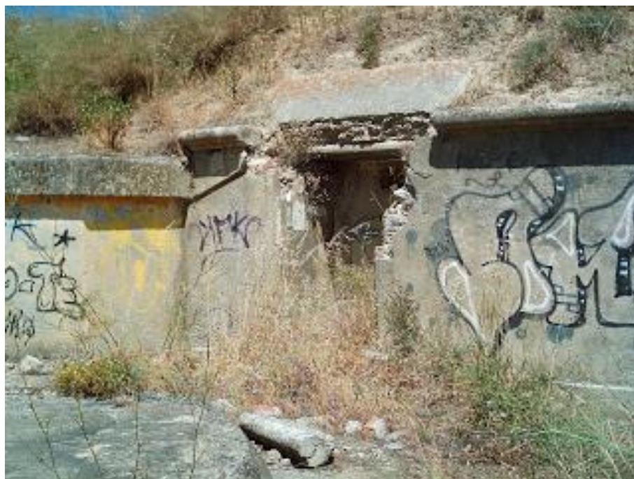
Fig. 25 – Patologia primária – Desabamento do lintel do vão correspondente ao elevador de munições, RAC (2011)
