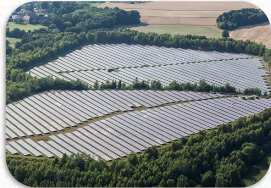
Parque solar, Portugal.
