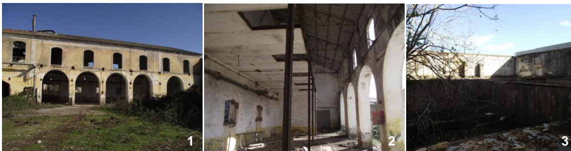
Figura 28 - Fotografias referentes ao edifício C 1 - Fachada Sudoeste; 2- Interior do edifício C; 3- Pátio interior;
