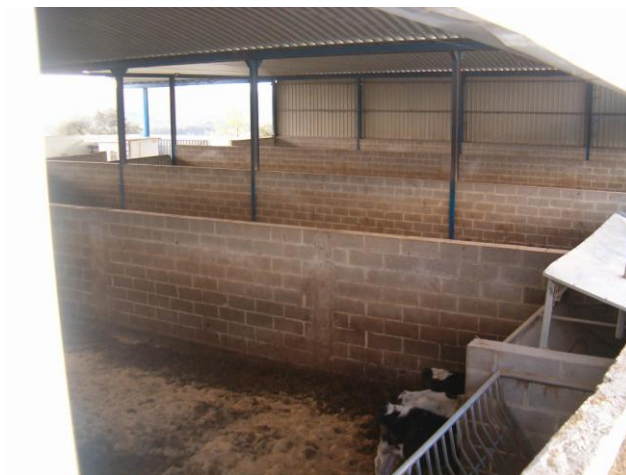
Figura 4- Separação de parques dentro de uma nave.
