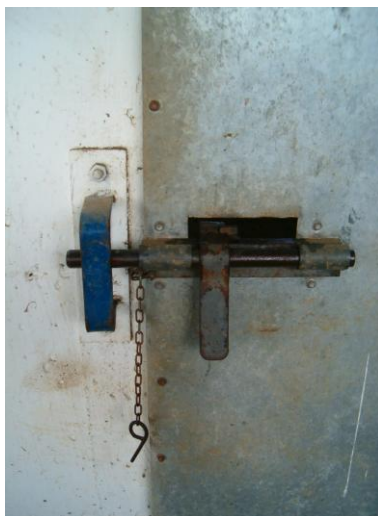
Figura 8- Sistema de fecho das portas dos parques cobertos.
