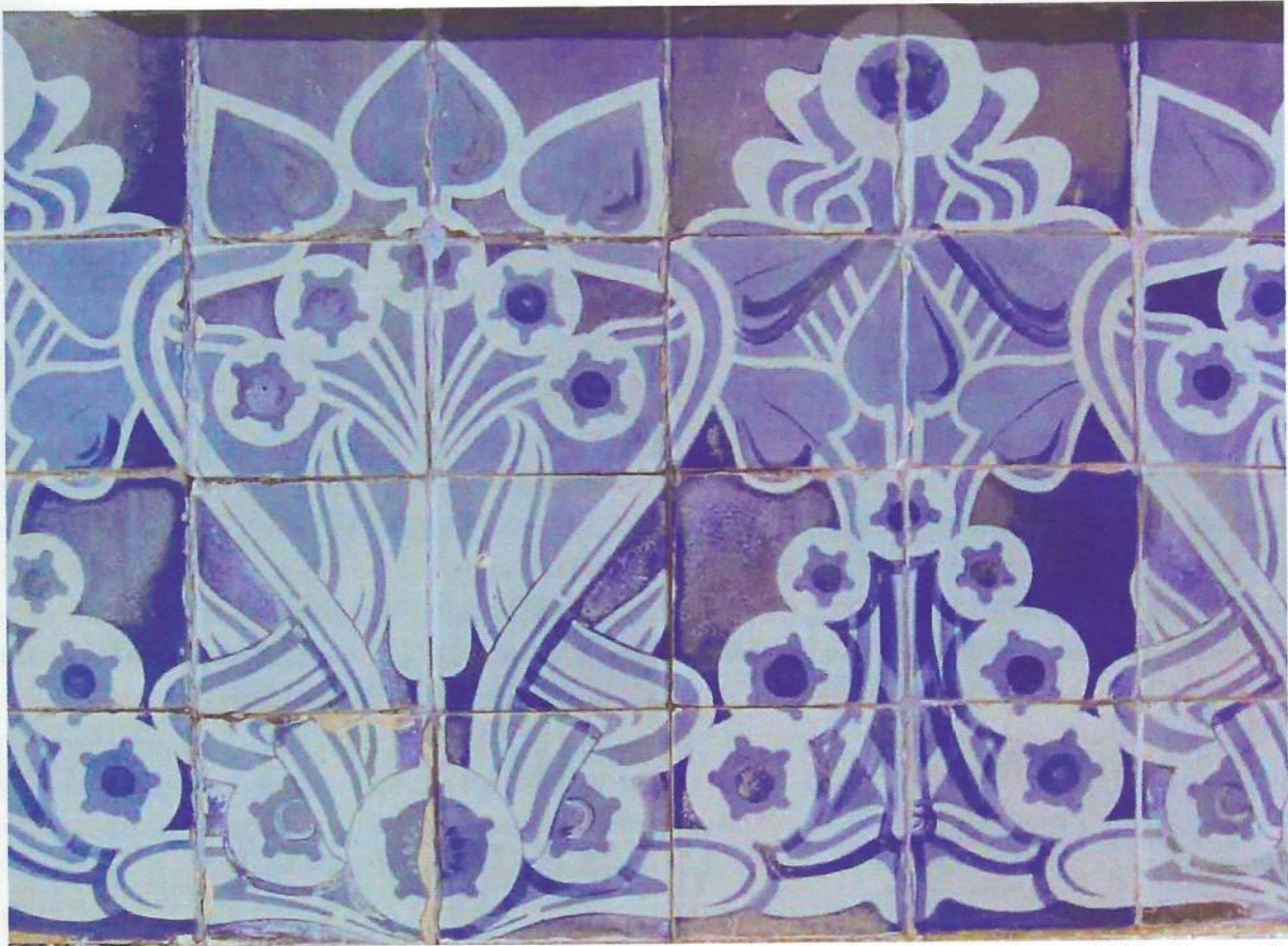
Ilustração 20 - Padrão de azulejos na fachada tardoz das Casas Álvaro Machado, pintado em 1908. O magnífico e complexo entrelaçar de formas vegetais estilizadas foram eximamente pintadas por José António Jorge Pinto (Fotografia do autor, Janeiro, 2010).
