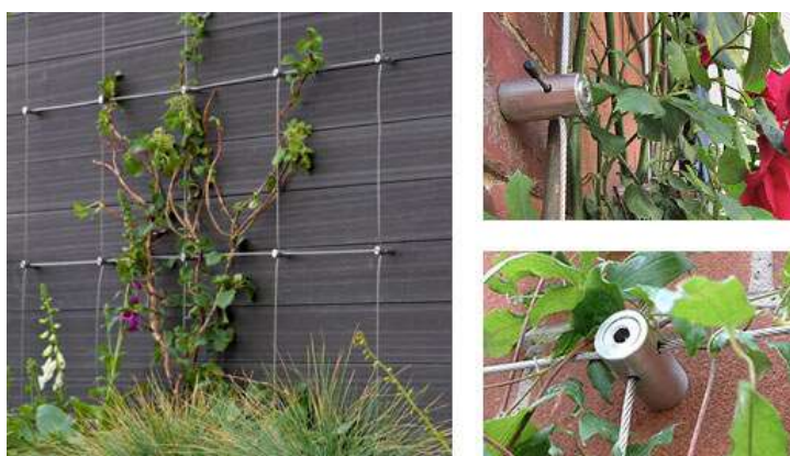
Figura 11 - Sistema de Cabos (Fonte:(S3i Group, 2018))
