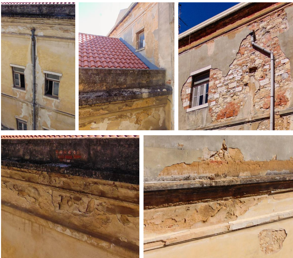
Fig. 91 - Detalhes do pátio de configuração triangular, onde se pode ver alvenarias expostas, perdas de reboco e diversas marcas de infiltrações e da presença de fungos. Fonte: a investigadora, 2017.
