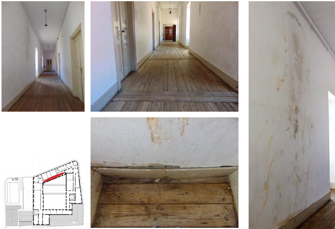
Fig. 114 - Em cima: corredor de circulação e pormenor do pavimento. Em baixo: pormenor do rodapé. À direita: parede com infiltrações. Fonte: a investigadora, 2017.
