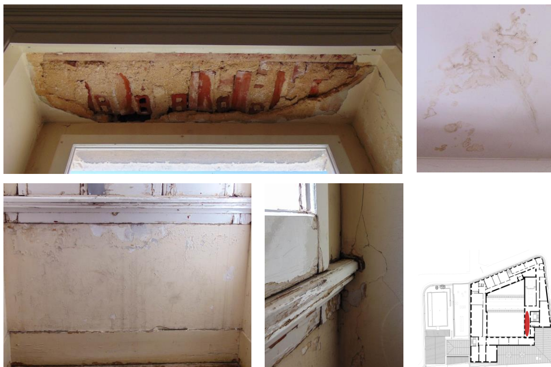
Fig. 106 - Detalhes do estado do edifício junto a uma das janelas do corredor e infiltrações no tecto (canto sup. dir.); piso 2. Fonte: a investigadora, 2017.
