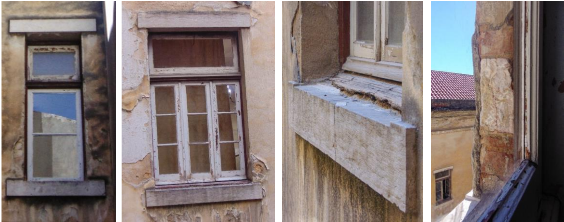
Fig. 99 – Janelas que deitam para o saguão e detalhes da degradação dos materiais. Fonte: a investigadora, 2017.
