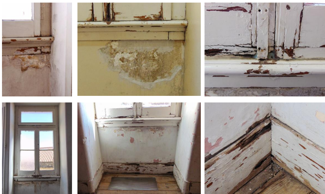
Fig. 107 - Detalhes que exibem a degradação de madeiras (caixilharia e rodapés) e de alvenarias. Fonte: a investigadora, 2017.
