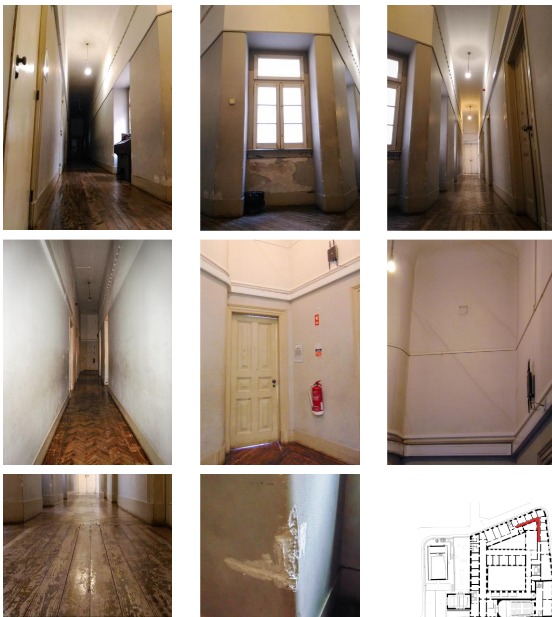
Fig. 97 - Corredor interior de circulação e detalhes mostrando o estado de degradação de paredes e pavimentos. Fonte: a investigadora, 2017.
