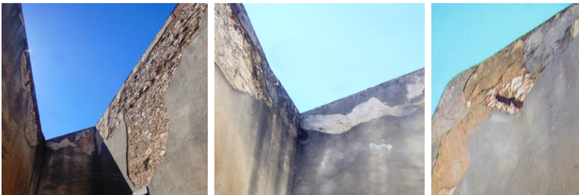
Fig. 100 - Saguão; Alvenaria exposta, infiltrações e fungos. Fonte: a investigadora, 2017.
