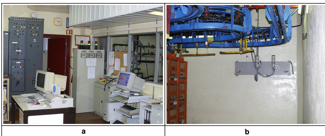
Figura 2.4: Sistemas de segurança e controlo da UTR.
