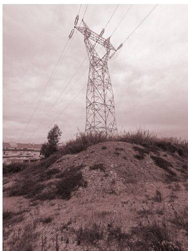
Figura 19 - Torre de alta tensão
