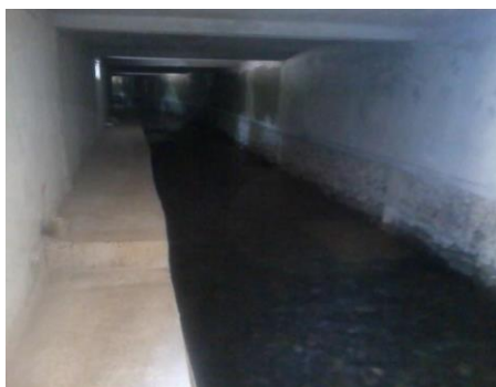
Figura 18: Condução de transporte de água bruta.
