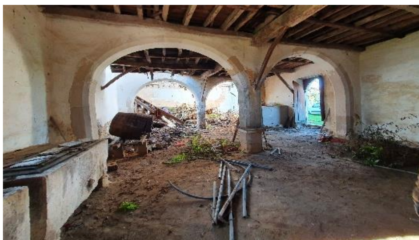
Figura 25 - Interior do Celeiro localizado a Poente da Torre primitiva. Fotografia do autor
