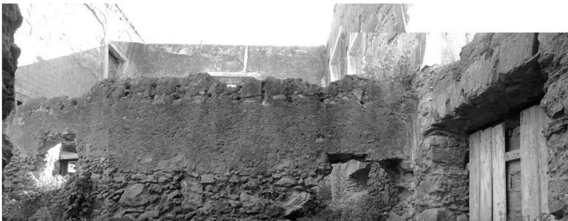
Fig. 33 – Estado de conservação dos interiores do Palácio
