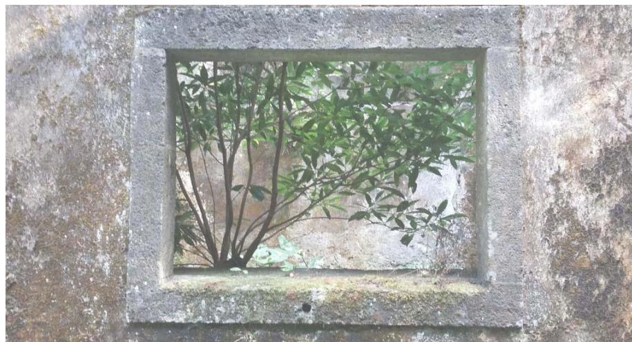
1- Vão na Casa Grená em ruína. Furnas, São Miguel.
