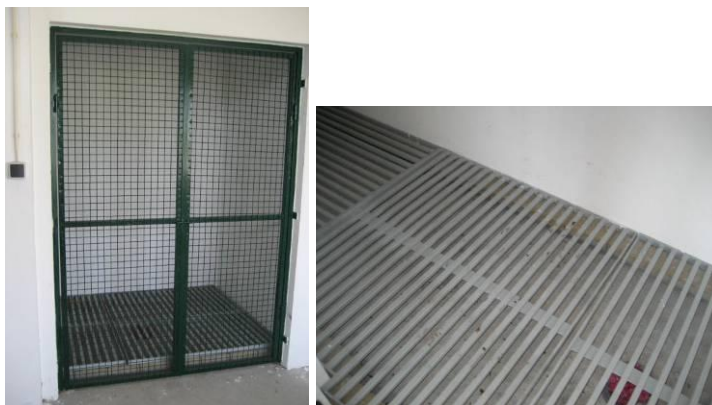
Figuras 86 e 87 – Local de armazenamento de produtos fitofarmacêuticos e bacia de retenção.
