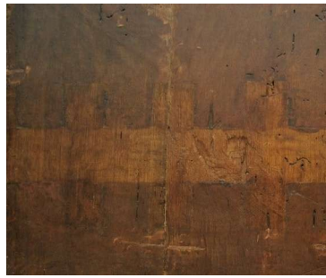
Figura 63: Marcas do sistema de reforço com travessas horizontais. ©VGN, 2017.
